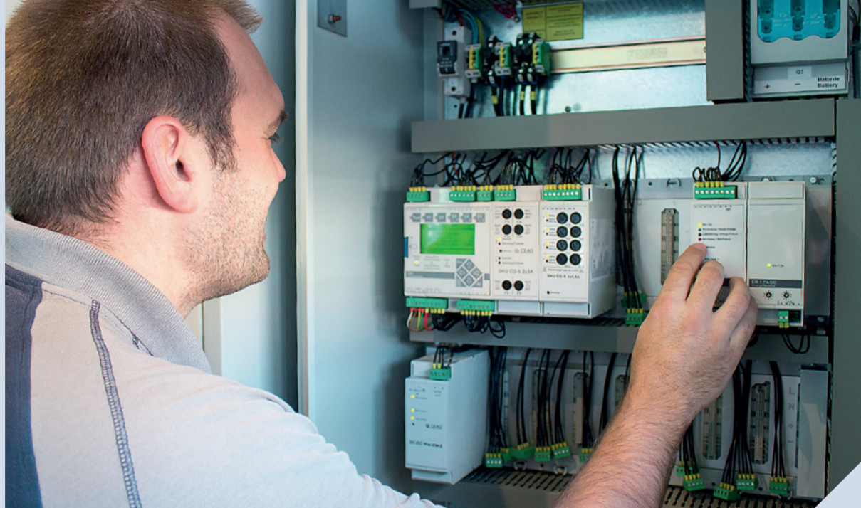
Der Servicetechniker stellt die Ladespannung ein.
